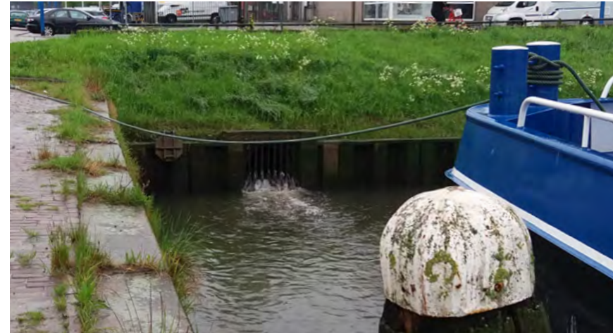
Belangrijk lozingspunt op de haven, oorspronkelijk voor vuilwater overstorten, nu steeds belangrijker voor "schoon" hemelwater
